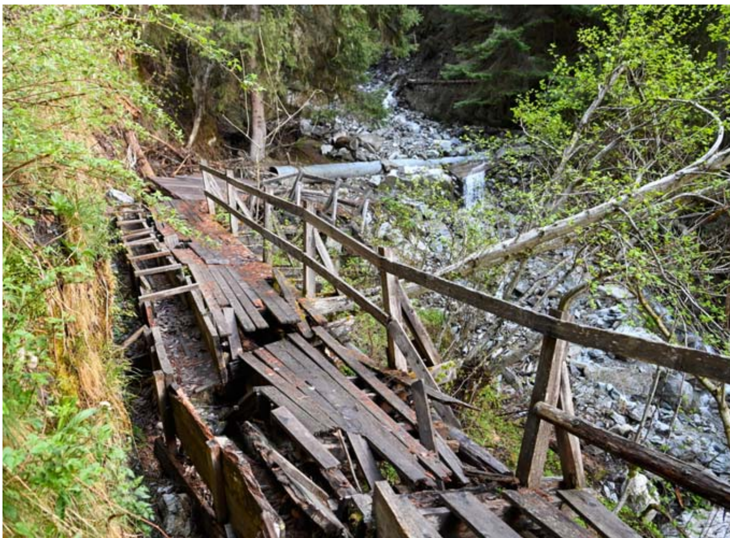
Passerelles arrachées, chéneaux cassés, sentier endommagé: le bisse de Vex porte encore les stigmates des intempéries. Ici, la passerelle du Doussin.
